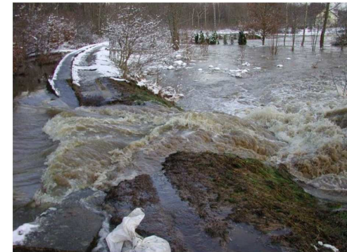
Rupture de digue à Soufflenheim (30 décembre 2001)
